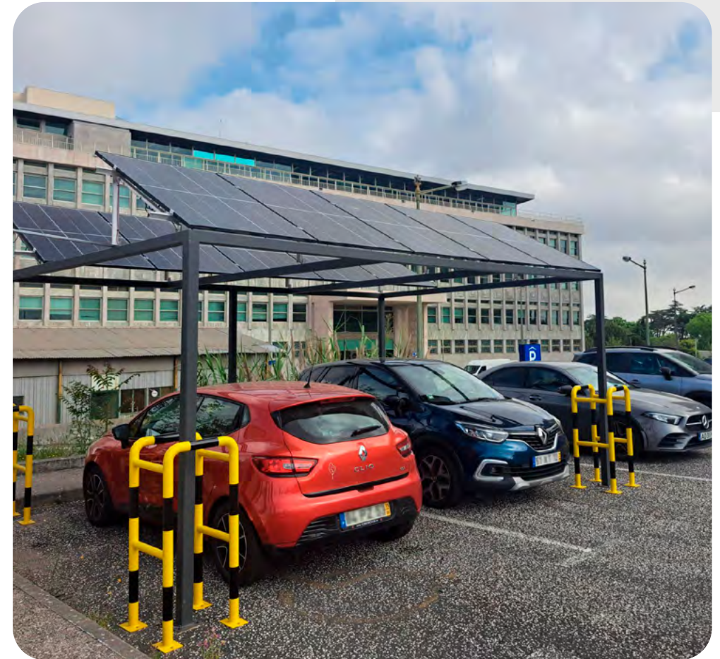
Marquesines fotovoltaïques a Saba Palácio da Justiça (Lisboa)
